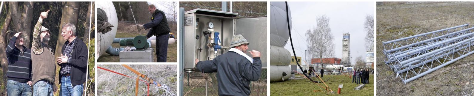
v.l.: Ballonbau Wörner (Matt jun., Matt sen., Wörner), Niederholwinden und Erdanker, Wasserstoff marsch!, Befüllung (im Hintergrund Linde-Werk), Elemente des Windmessturms liegen für Tests bereit
